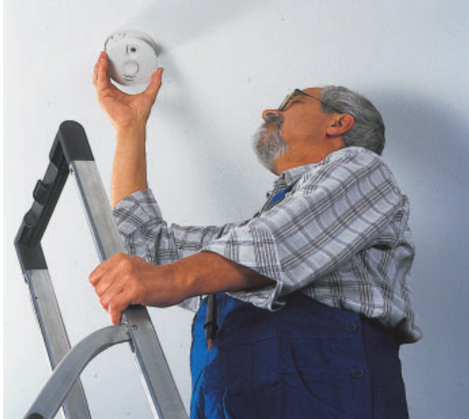
Rauchmelder an Decke montiert
